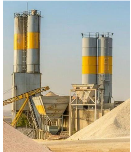
Usine d'essai Lixhe Belgium – Projet Leilac UE (Fig. 1)
